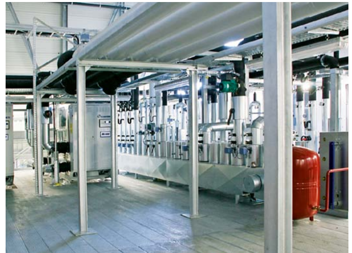
Das Bild zeigt einen Teil des Energieverbundsystems mit den beiden Wärmepumpen.
