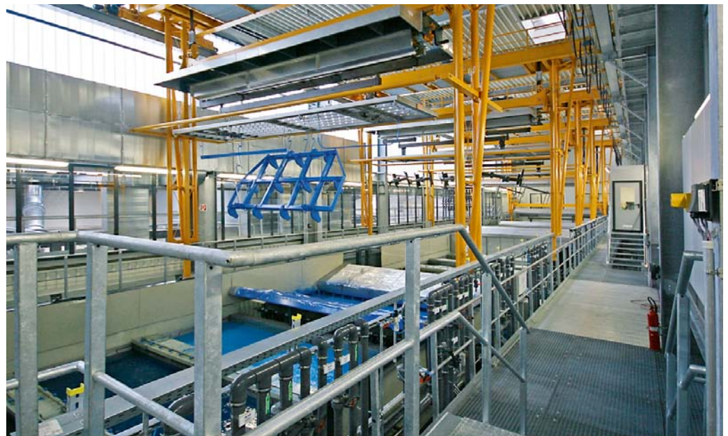
Blick in den VBH-/KTL-Badbereich: Dieser ist für Werkstücke bis 6 m Länge, 1,5 m Breite und 3 m Höhe ausgelegt. Die maximale Traglast der Deckenfahrwerke liegt bei 5 t.
